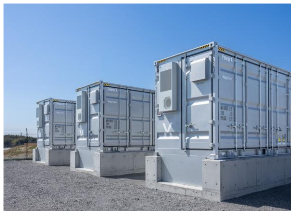
右：「東浦蓄電所」（愛知県知多郡東浦町）
